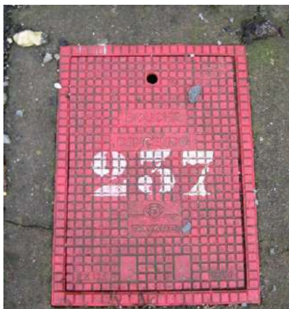
Exemples de numérotation sur des points d'eau incendie
